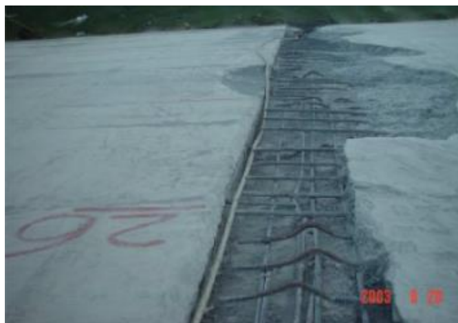
Рисунок 18 – Трещины в экране плотины Tianshengqiao-1 [41]
