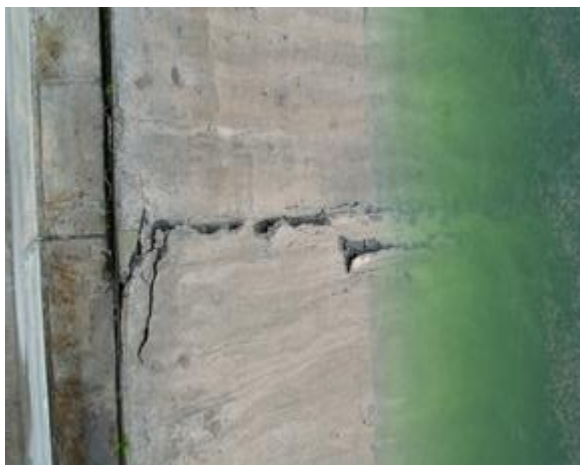
Рисунок 19 – Трещины в экране плотины Mohale [44]
