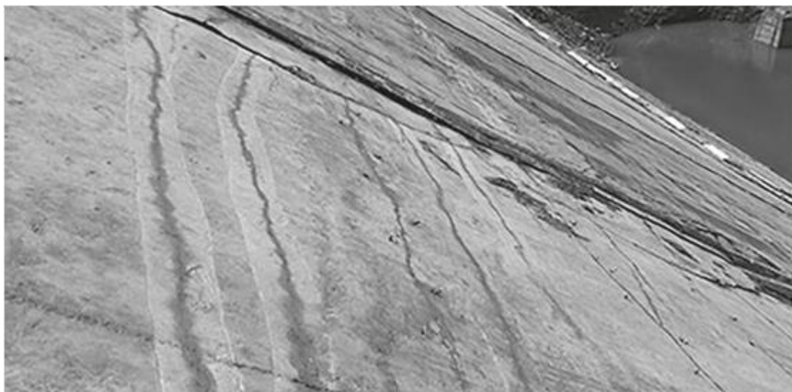
Рисунок 20 – Горизонтальные трещины в экране плотины Вухі [43]
