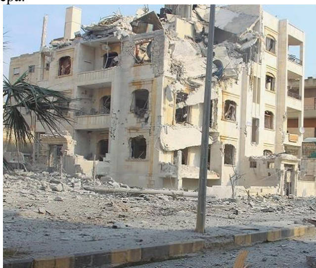
Рис. 1. Фотография поврежденного железобетонного здания
