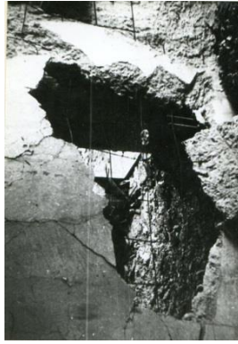
Рис. 1. Взрывообразное разрушение влажной железобетонной конструкции при воздействии пожара
